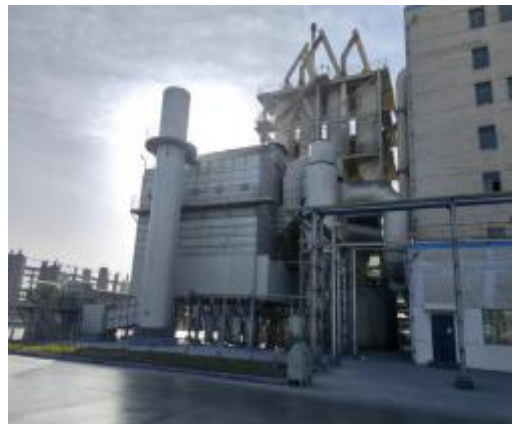
6#电石炉除尘器
