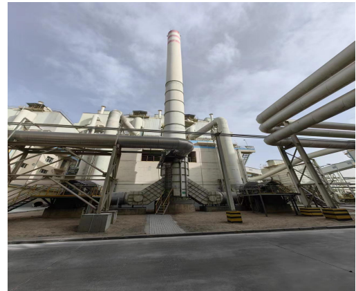
石灰窑尾气除尘器
