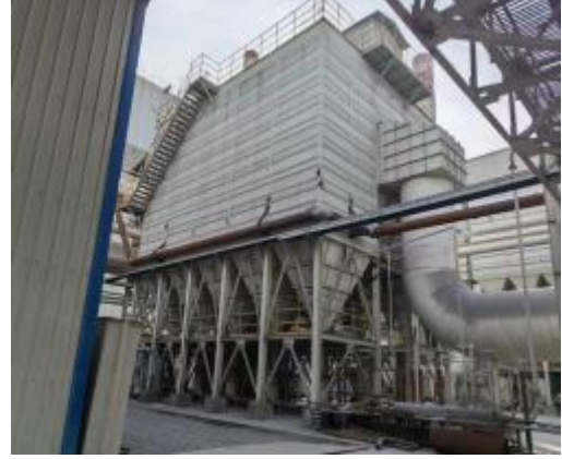
石灰石环境除尘器
