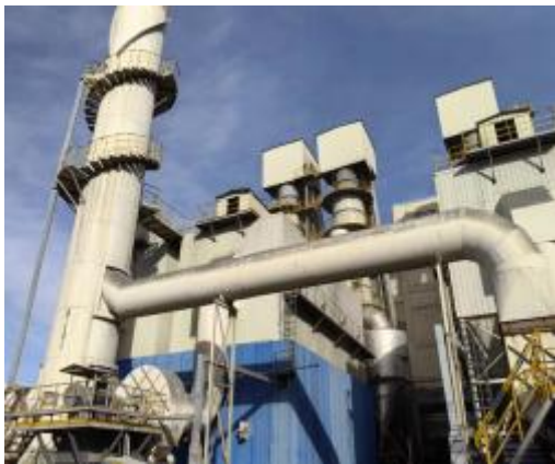
兰炭干燥废气除尘器
