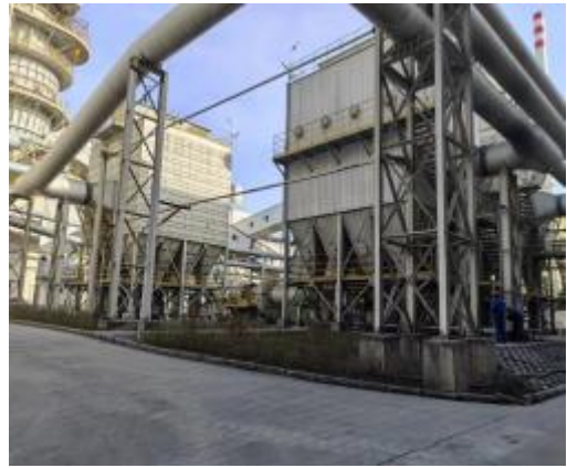
兰炭出料除尘器
