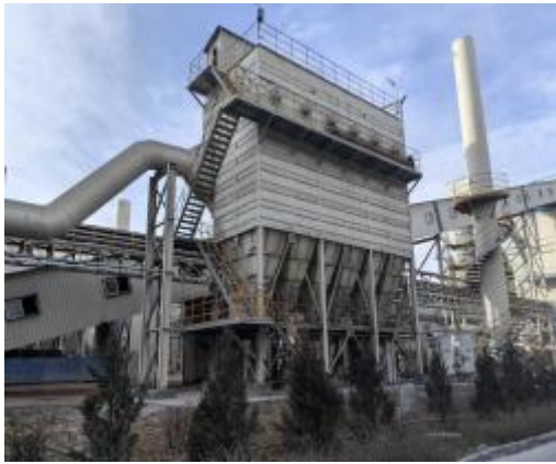
兰炭上料除尘器
