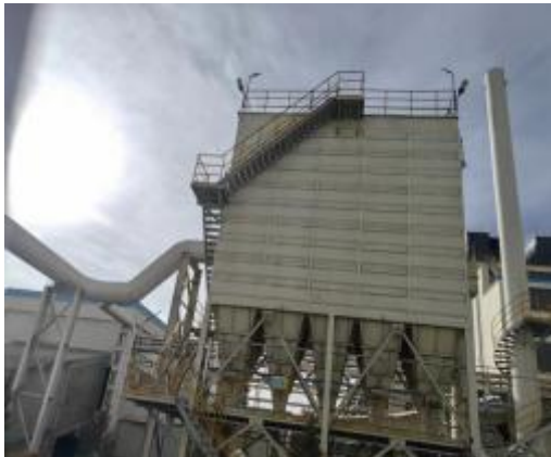
石灰石上料除尘器
