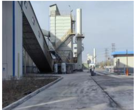
石灰石卸料除尘器
